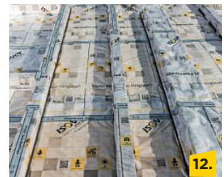
12. Vario® KM Duplex UV ist nun vollständig verlegt und fachgemäß luftdicht angeschlossen.
