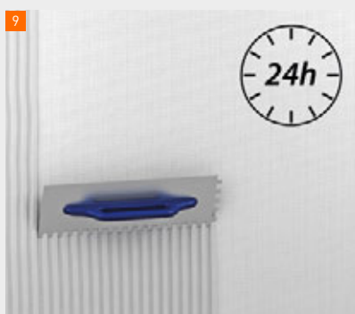
Aufbringen der zweiten Putzschicht 2–3 mm fermacell™ HD Leichtmörtel nach Erhärten der Armierungsschicht (Variante A)
