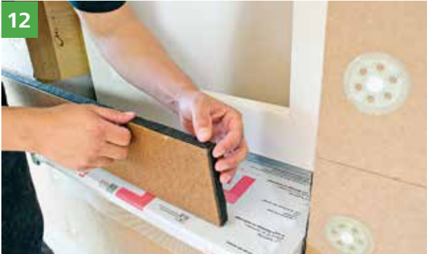
12 Montage der Laibungsplatte. Schlagregenschutz durch Anbringung von Fugendichtbändern an der Front- und Stirnkante.
