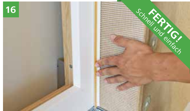
16 Anbringen einer geeigneter Anputzleiste für den sicheren Putzabschluss und Fortführung der WDVS Arbeiten.
